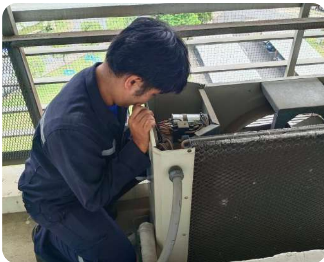
มีการตรวจสอบและบำรุงรักษาเครื่องปรับอากาศ ปีละ 4 ครั้ง
